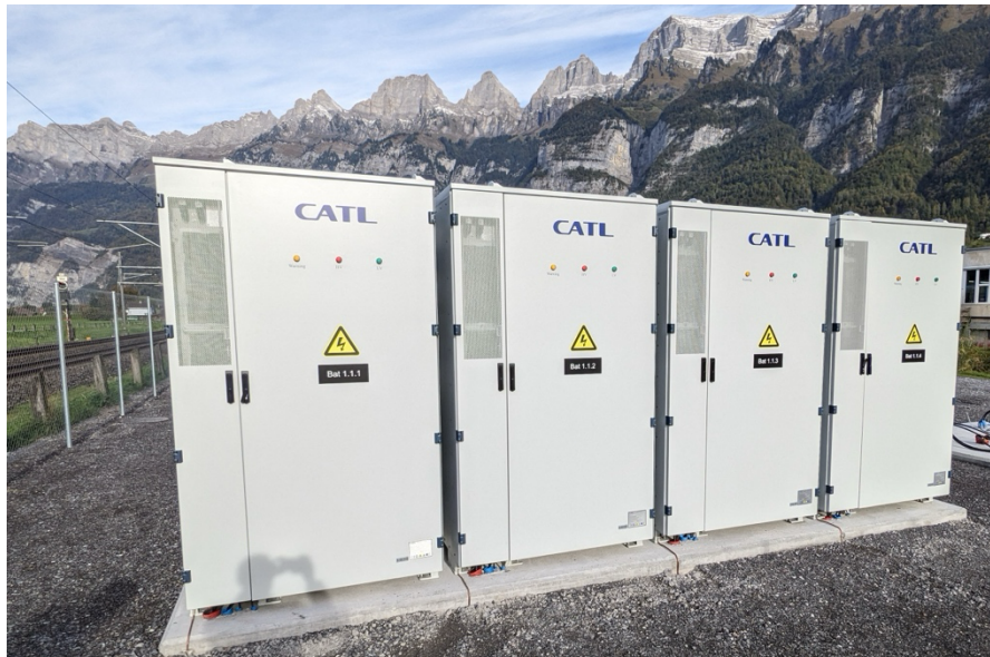
Grid-scale batteries in Walenstadt. Picture credit: 49komma8 AG
